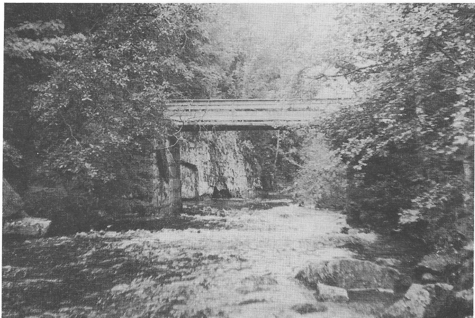
Nyere bro på restene av reguleringsdemningen i Dausjøelva. (Foto: S. Reinholdt sept. -86)
