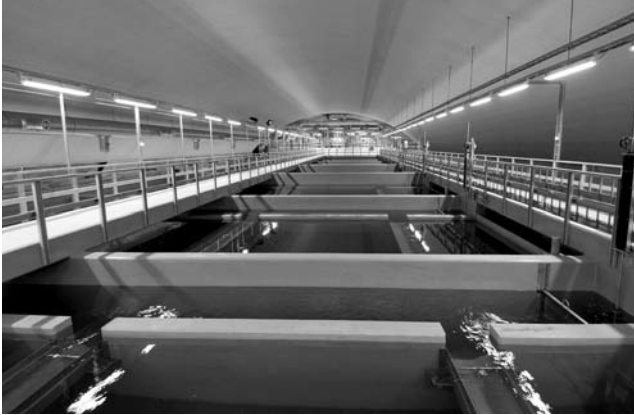
Høyt teknologi på nye Oset; UV-filter erstatter klortilsetting i drikkevannet. Foto: VAV
